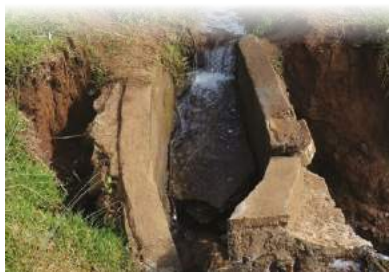
Ouvrage dégradé suite à une crue
