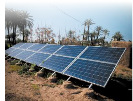
Dispositif de pompage solaire, Maroc
