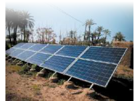
Dispositif de pompage solaire, Maroc
