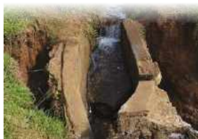
Ouvrage dégradé suite à une crue
